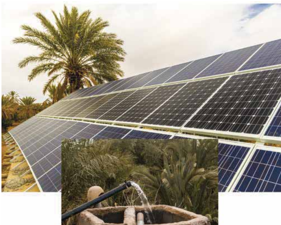
Les pompes solaires, installées dans le cadre du Programme des Oasis du Tafilalet, permettent aux coopératives agricoles de réaliser des économies sur la facture d'électricité et de rationaliser l'utilisation de l'eau.
